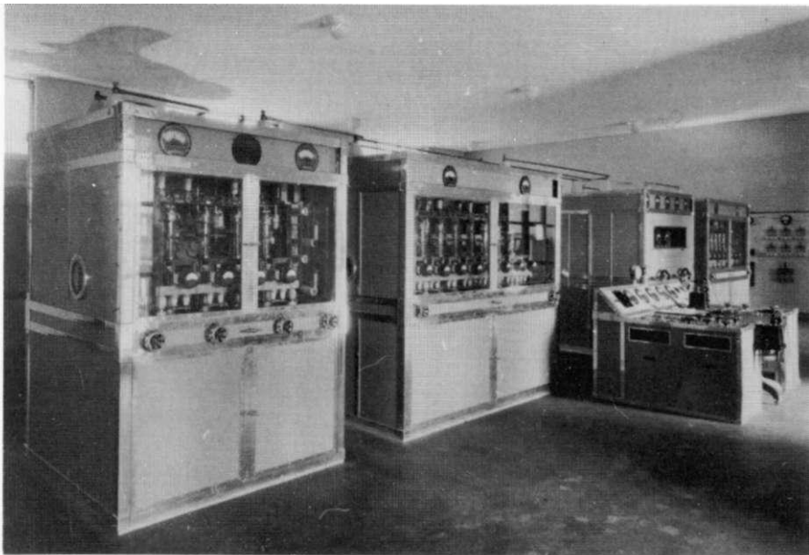
Sändarapparaturen monterad i slutna skåp Kontrollbordet till höger
